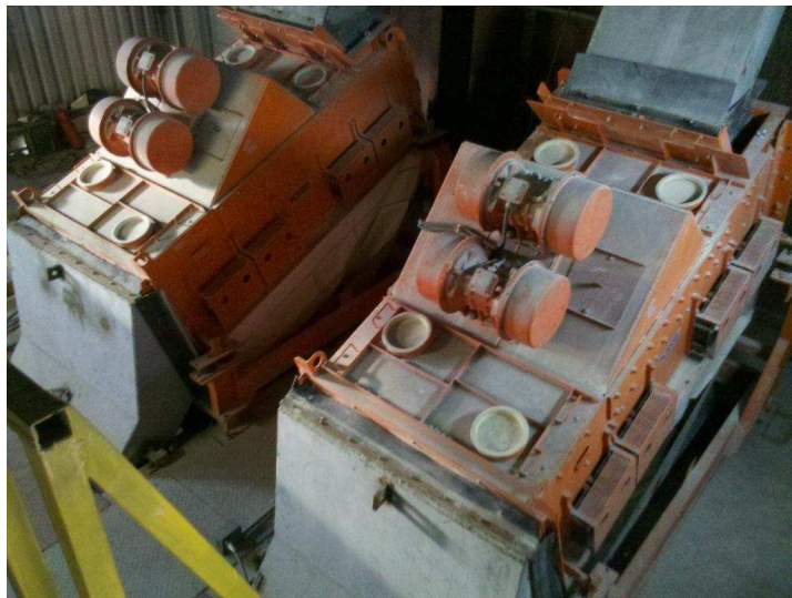
Участок подготовки шихты на отметке 40 метров.
